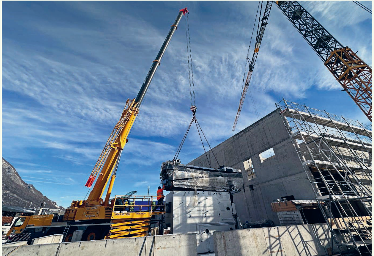
La chaudière à plaquettes de bois, d'une puissance d'environ 2,5 MW, fournit la majeure partie de l'énergie de chauffage.
